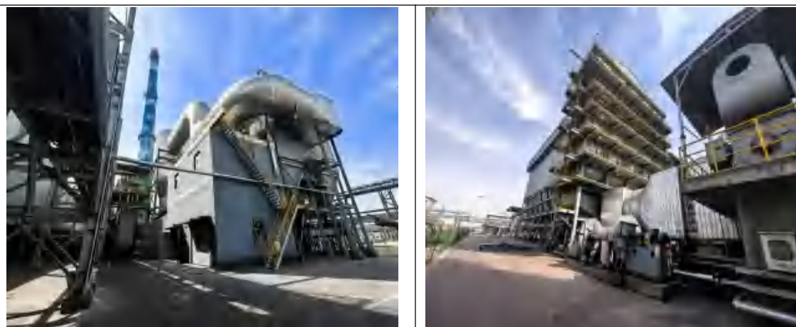
A 组捣固焦炉 \text{NaHCO}_3 干法脱硫装置+布袋除尘器+SCR 选择性催化还原脱硝+135m 高排气筒
