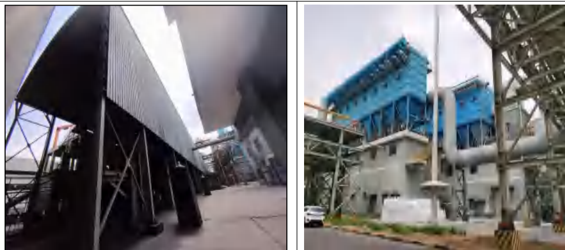
D 组焦侧空间封闭大棚+布袋除尘器
