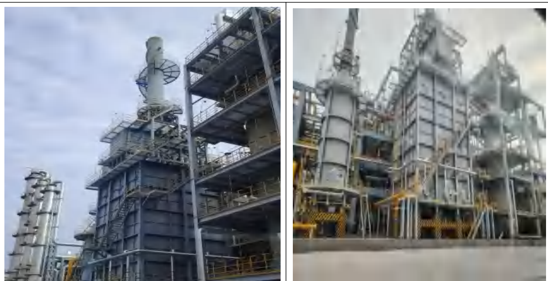
甲醇工段 2 台转化预热炉+2 个 42.6m 高排气筒
