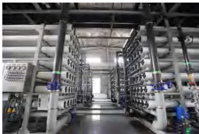
中水回用水处理站
