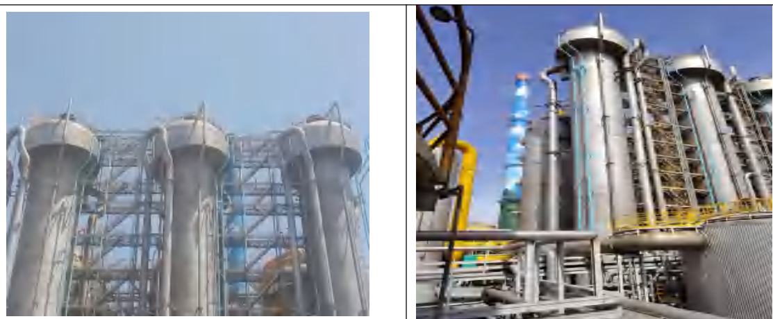
脱硫再生塔顶尾气设置 2 套脱硫系统
